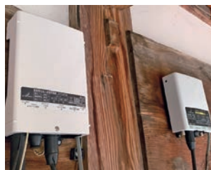
新しくなった ケーブルテレビ設備
